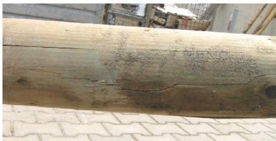
Abbildung 51: 1.Beispiel für sichtbaren Bruch an der Mastoberfläche
