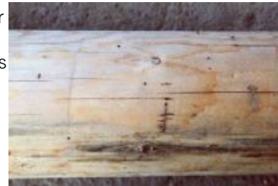
Abbildung 54: Insektenbefall am Holzmast (Beispiel zulässig)
