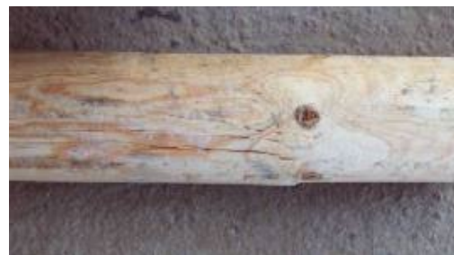
Abbildung 52: 2.Beispiel für sichtbaren Bruch an der Mastoberfläche
