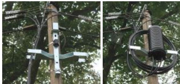
Abbildung 44: Überlängenkreuz mit E&MMS-Muffe und korrekt aufgewickeltem Kabelvorrat
